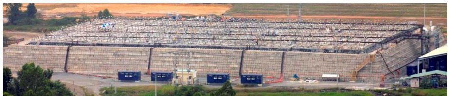
Mố xử lý nhiệt đang vận hành
